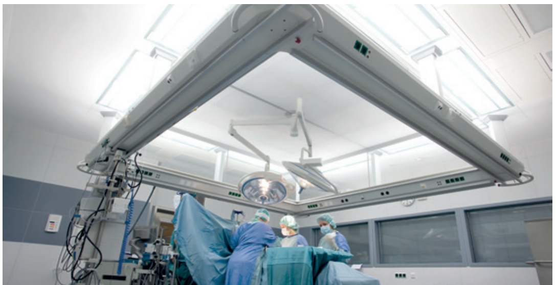
Abbildung 4.42: Der multifunktional beleuchtete OP-Raum
