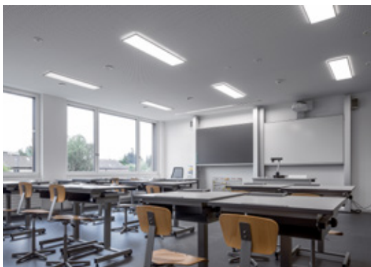
(a) Beleuchtung mit Anbauleuchten mit konstanter Farbtemperatur (4.000 K)
